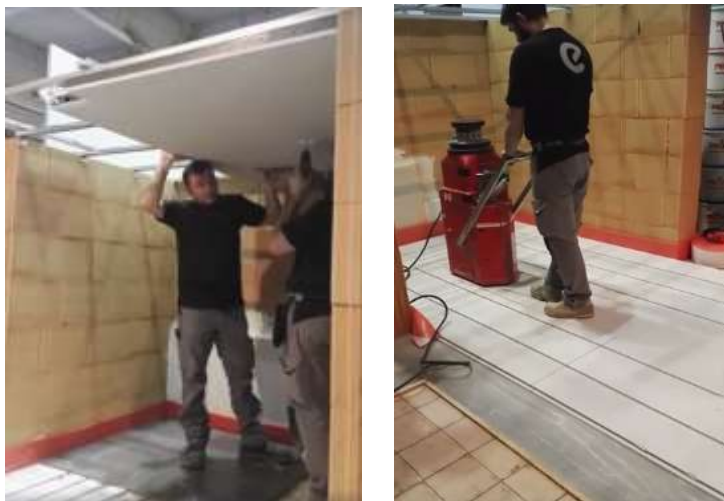
Figura 8. Installazione di un soffitto radiante (a sinistra) e di un pavimento radiante (a destra) presso lo stand lvh.apa
